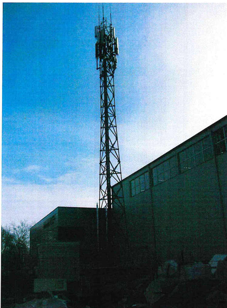
Zał. nr 1: Widok ogólny instalacji radiokomunikacyjnej.
