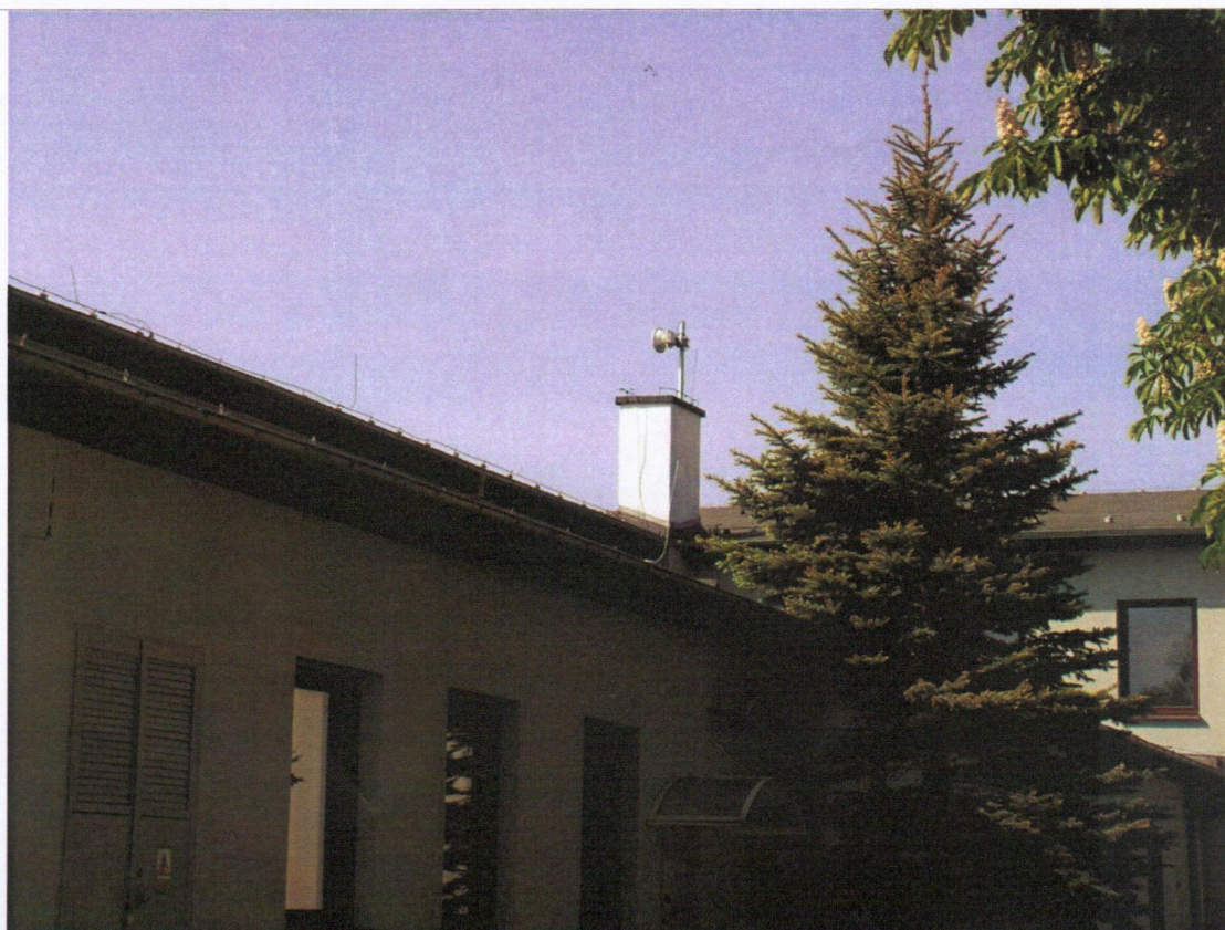
Fot. 1. OM Wrocław / ul. Karmelkowa – widok anteny linii radiowej na dachu budynku
