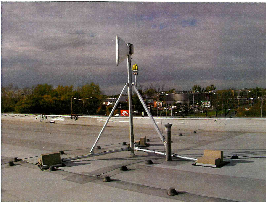
Fot. 1. OM Wrocław / ul Żmigrodzka 145 – widok anteny Emitel na dachu budynku
