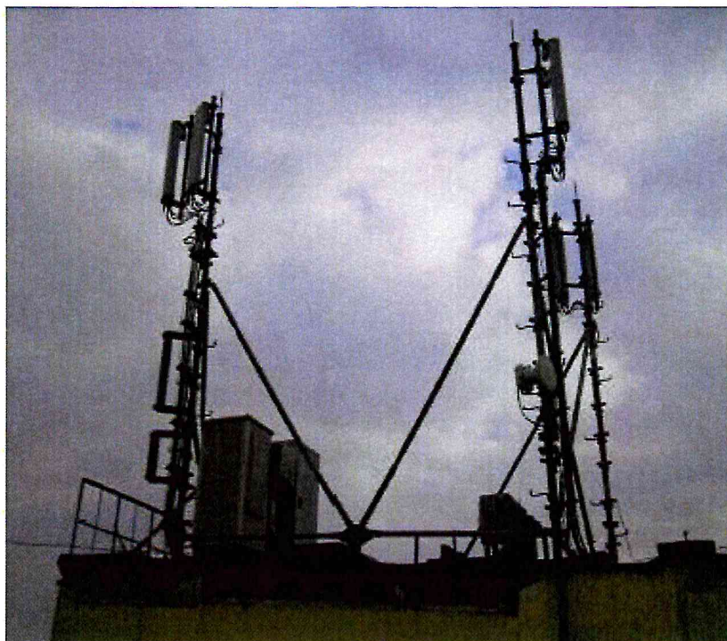
Zał. nr 1: Widok ogólny instalacji radiokomunikacyjnej.
