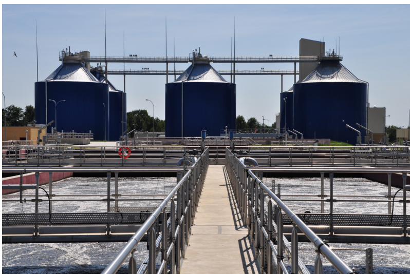
Reaktory biologiczne i WKF-y Wrocławskiej Oczyszczalni
