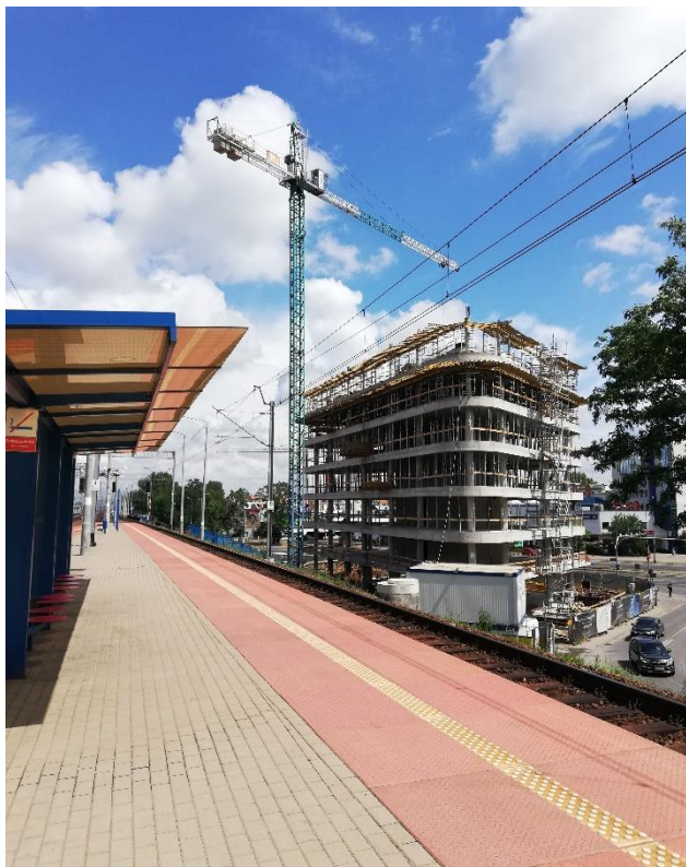
Rys. 4.5 Budowa kompleksu biurowego Business Garden w bezpośrednim sąsiedztwie stacji kolejowej Wrocław Mikołajów oraz głównego ciągu tramwajowego na Legnickiej.
