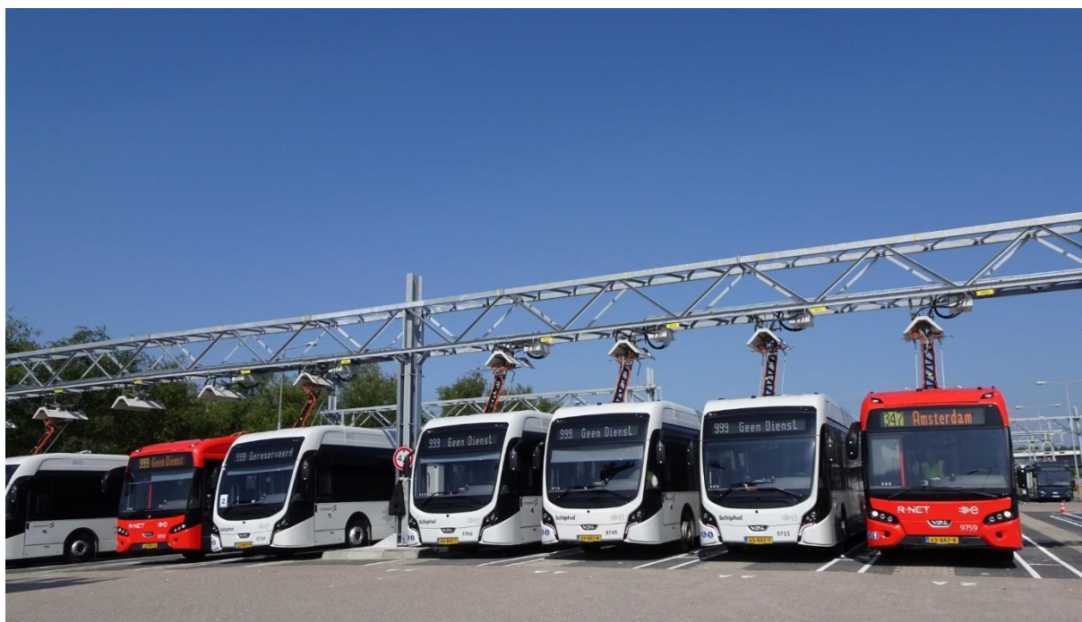
Rys. 6.6 System ładowarek pantografowych na zajezdni 59
