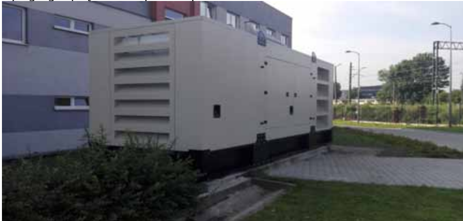
Nowy agregat prądowłórczy o mocy 1000kVA
