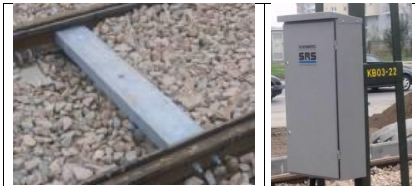
Rysunek 30. Przykład smarownicy torowej SRS oraz szafy z aparaturą sterowniczą smarownicy ( http://www.transportszynowy.pl )
