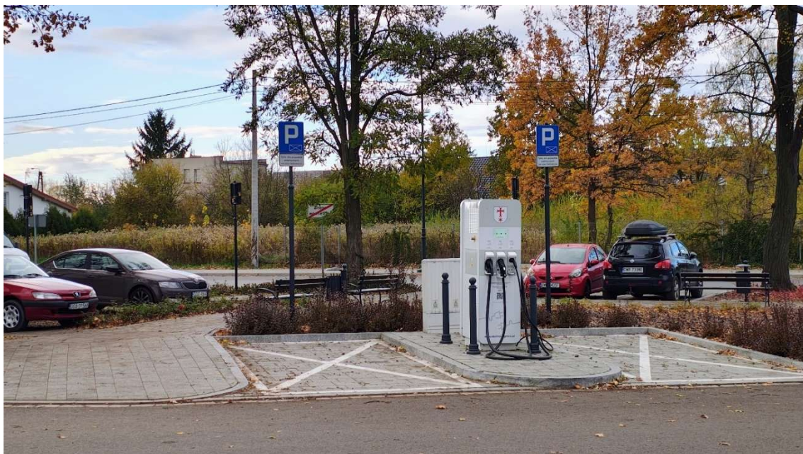
Rysunek 25. Gmina Siechnice – stacja ładowania pojazdów przy stacji kolejowej Św. Katarzyna
