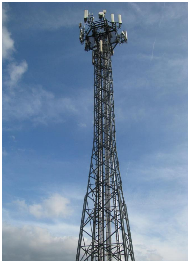
Zał. nr 1: Widok ogólny instalacji radiokomunikacyjnej.
