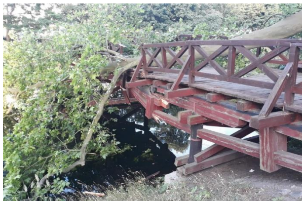
Fotografia 82. Konstrukcja kładki Świętego Antoniego przed remontem
