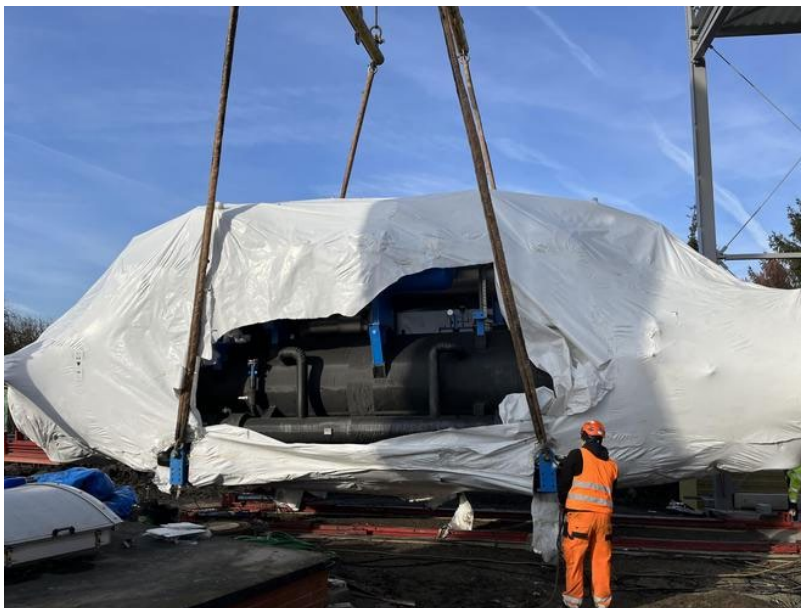
Rysunek 2-8 Budowa pompy ciepła o mocy 12,5 MW wraz z niezbędną infrastrukturą towarzyszącą
