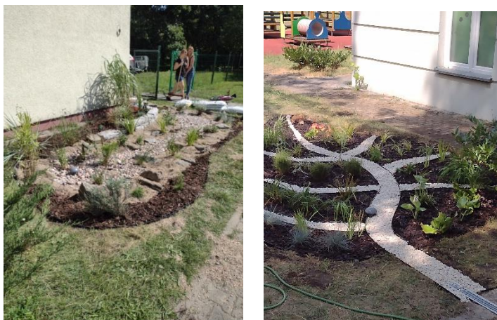
Ogrody deszczowe zrealizowane w projekcie „Lubię deszcz”
