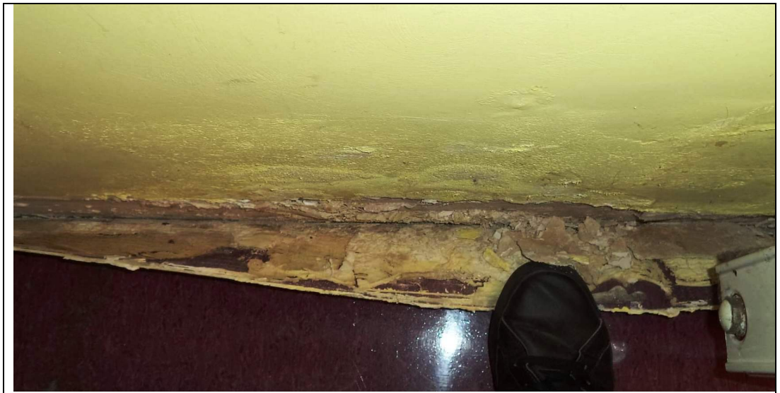
Foto 1, 2 pok. nr 0/15 od strony zachodniej, widoczne zawilgocenia ściany oraz posadzki.
