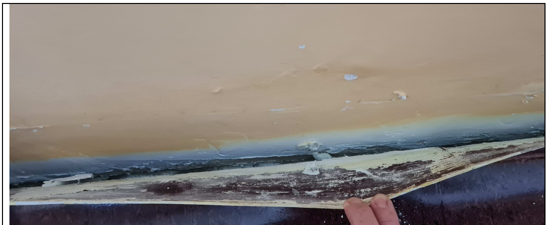
Foto 3 zawilgocenia krótko po próbach remontu (usunięciu zawilgoczeń).
