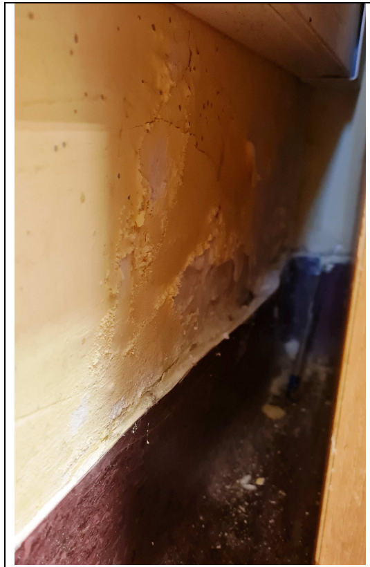
Foto 4. Widoczne spudrowanie powierzchni tynku i szpachli gipsowych wraz z farbą, widoczne drobne naloty soli osadzających się na powierzchni. Widoczne ciemne ogniska zarodników grzybni – brak cyrkulacji powietrza.
