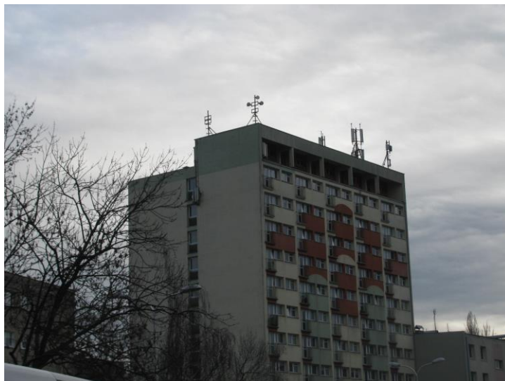
Zał. nr 1: Widok ogólny instalacji radiokomunikacyjnej.
