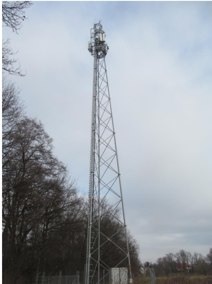
Zał. nr 1: Widok ogólny instalacji radiokomunikacyjnej.
