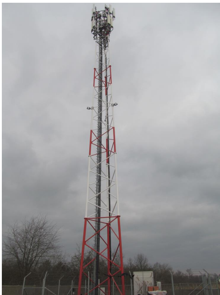
Zał. nr 1: Widok ogólny instalacji radiokomunikacyjnej.
