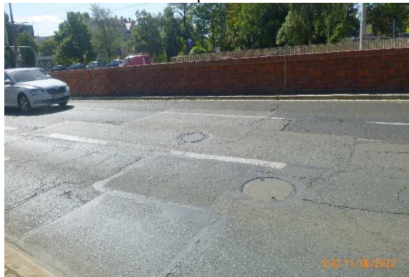
Fot. 59. ul. Oławska - przed remontem
