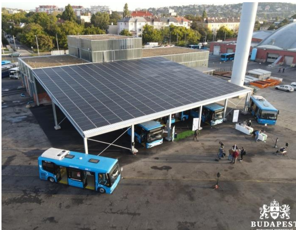
Zdjęcie 19 Zadaszenie stacji autobusowej w Budapeszcie (moc instalacji - 200 kWp)
