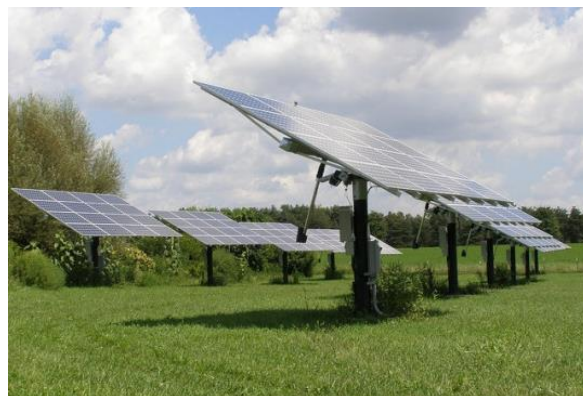
Zdjęcie 2 Wolnostojąca instalacja PV z trackerem solarnym
