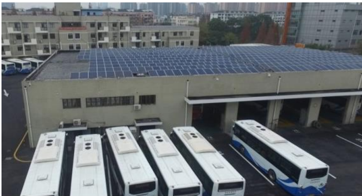
Zdjęcie 16 Wykorzystanie dachu jednej z zajezdni autobusowej w Szanghaju (moc sumaryczna paneli PV - 195 kWp)
