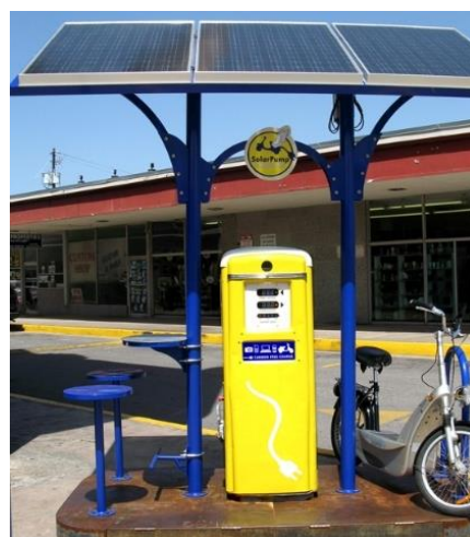
Zdjęcie 13 Komercyjna, solarna (3x 195 Wp) stacja ładowania rowerów elektrycznych
