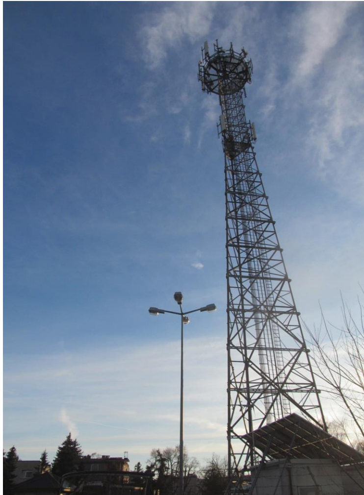
Zał. nr 1: Widok ogólny instalacji radiokomunikacyjnej.
