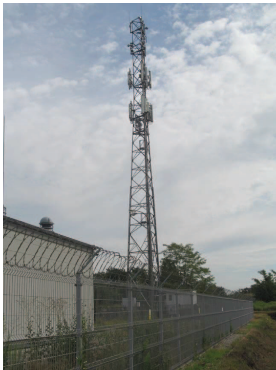
Zał. nr 1: Widok ogólny instalacji radiokomunikacyjnej.
