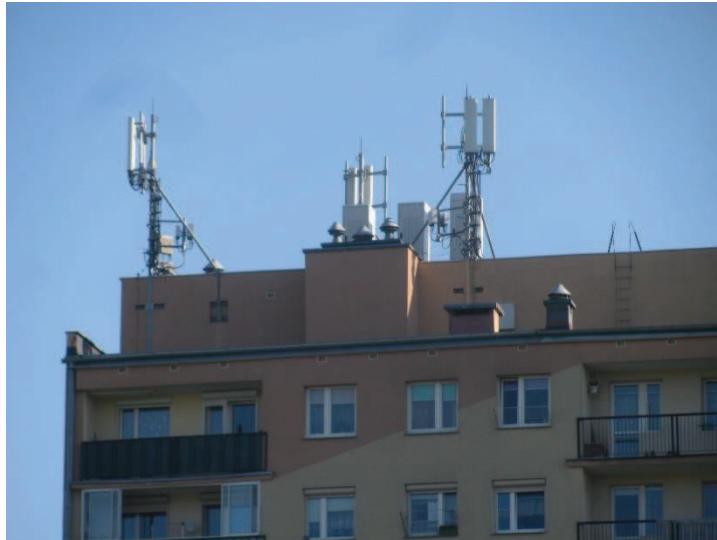
Zał. nr 1: Widok ogólny instalacji radiokomunikacyjnej.
