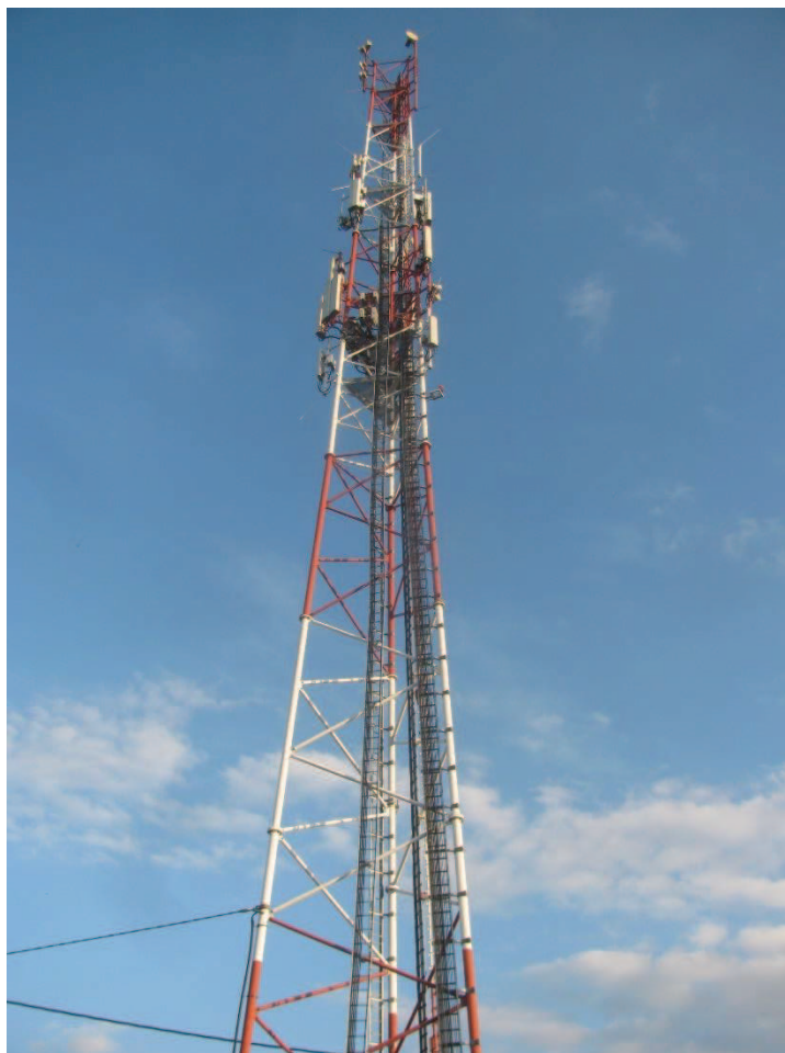
Zał. nr 1: Widok ogólny instalacji radiokomunikacyjnej.
