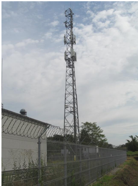
Zał. nr 1: Widok ogólny instalacji radiokomunikacyjnej.
