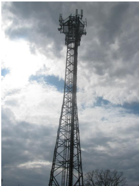
Zał. nr 1: Widok ogólny instalacji radiokomunikacyjnej.
