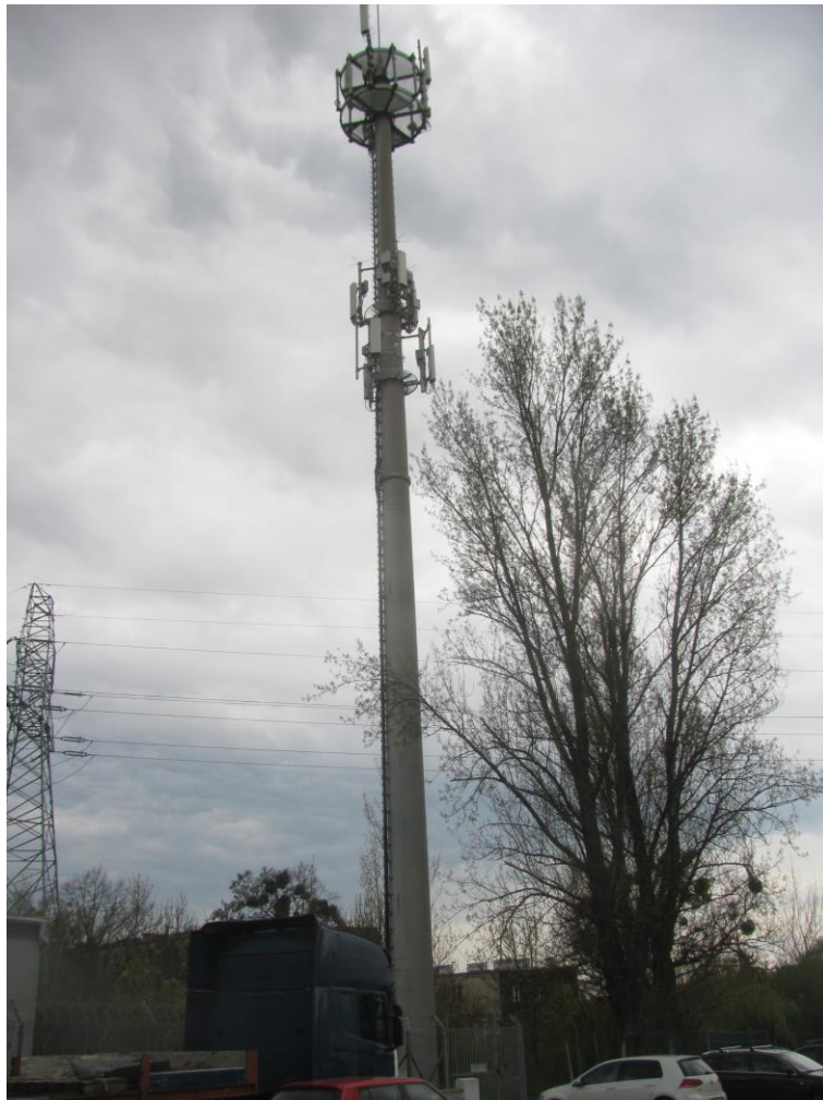
Zał. nr 1: Widok ogólny instalacji radiokomunikacyjnej.
