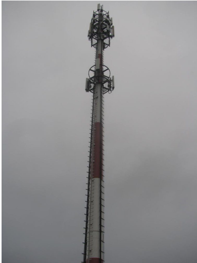
Zał. nr 1: Widok ogólny instalacji radiokomunikacyjnej.
