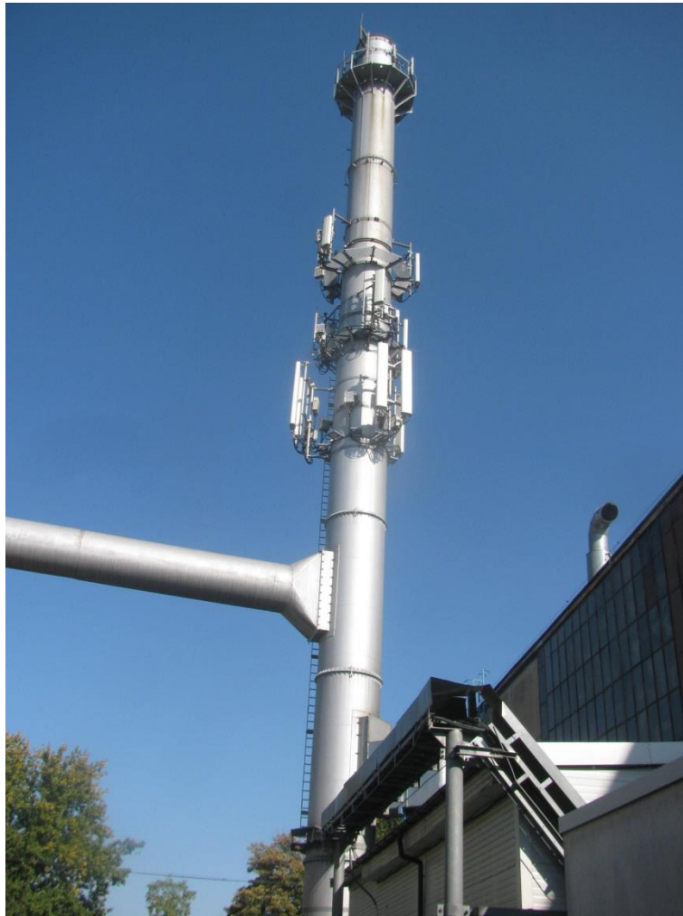
Zał. nr 1: Widok ogólny instalacji radiokomunikacyjnej.
