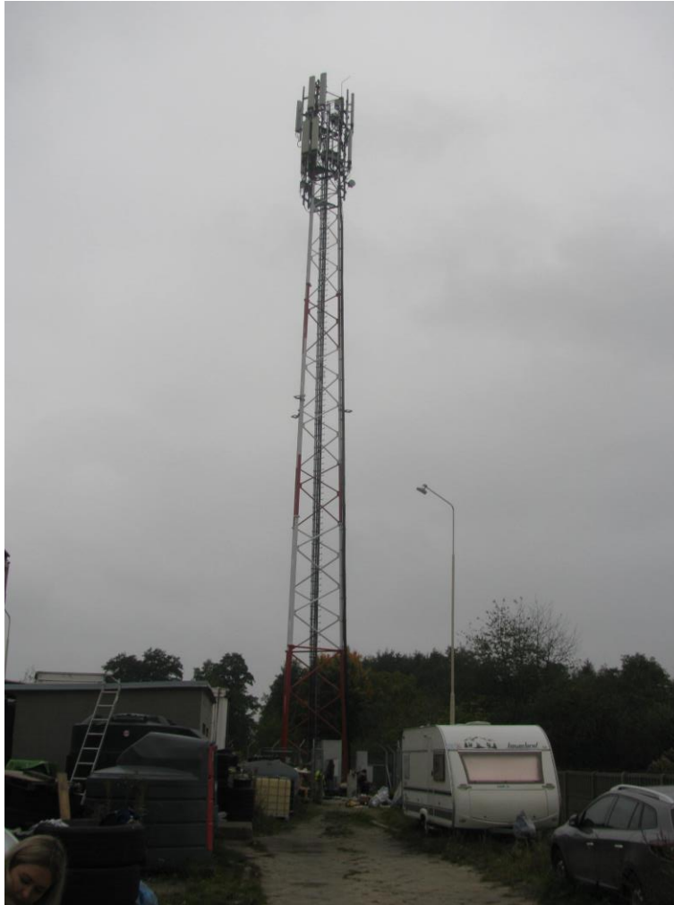
Zał. nr 1: Widok ogólny instalacji radiokomunikacyjnej.
