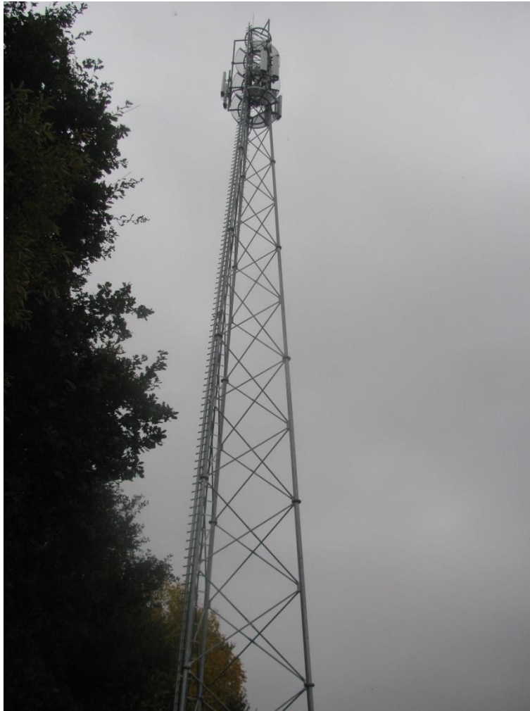
Zał. nr 1: Widok ogólny instalacji radiokomunikacyjnej.
