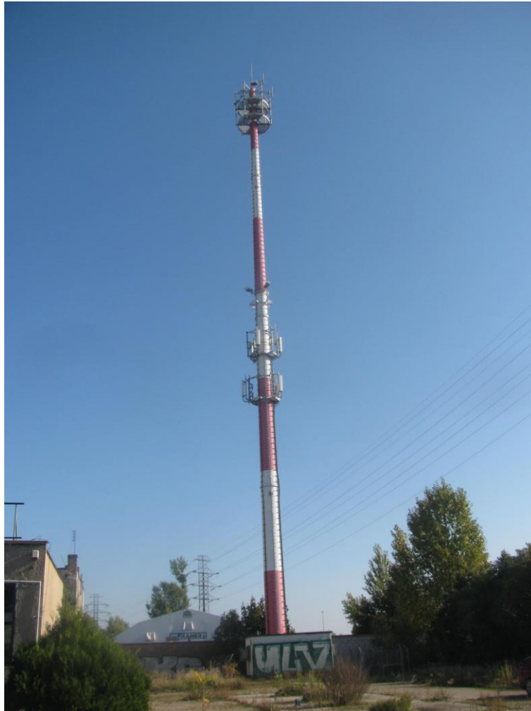
Zał. nr 1: Widok ogólny instalacji radiokomunikacyjnej.
