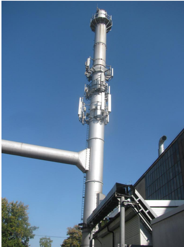
Zał. nr 1: Widok ogólny instalacji radiokomunikacyjnej.
