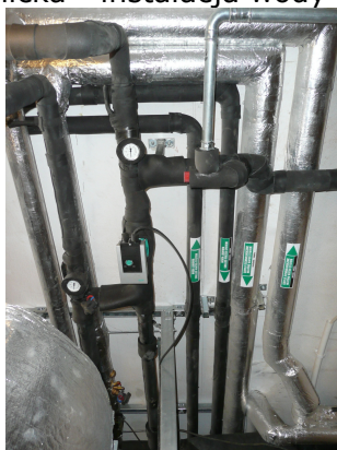
Piwnica Świdnicka - instalacja wody lodowej
