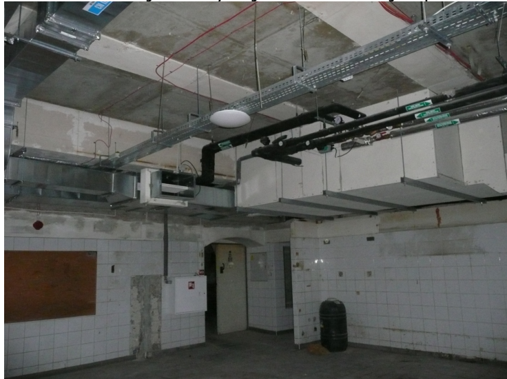
Piwnica Świdnicka - centrala wentylacyjna
